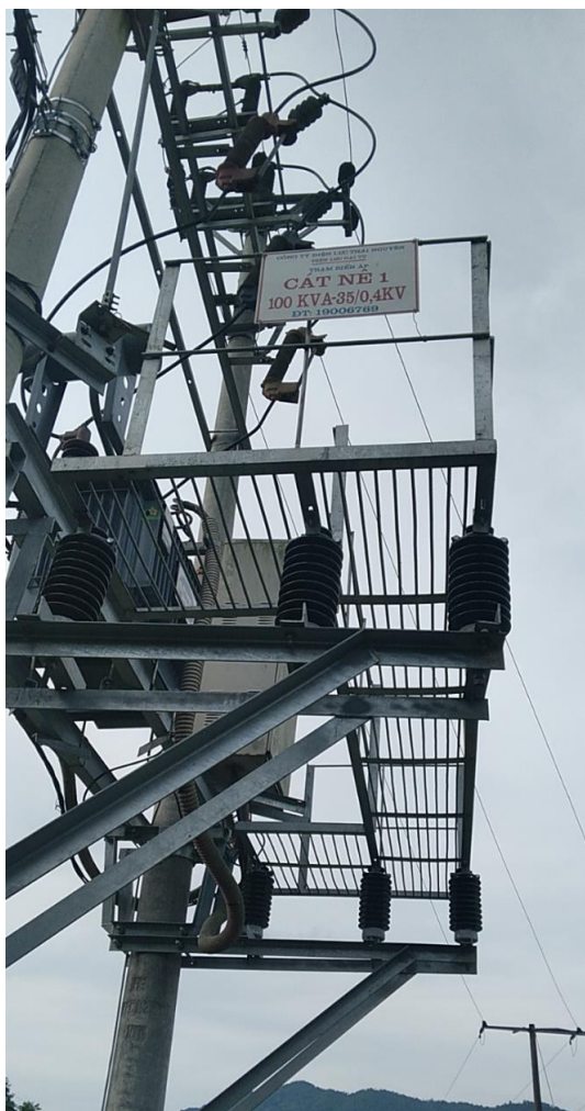
Trạm biến áp Cát Nê 1
