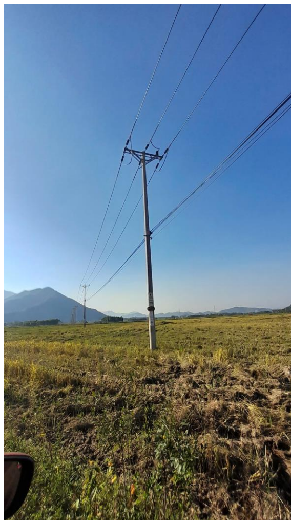
Đường dây 35kv
